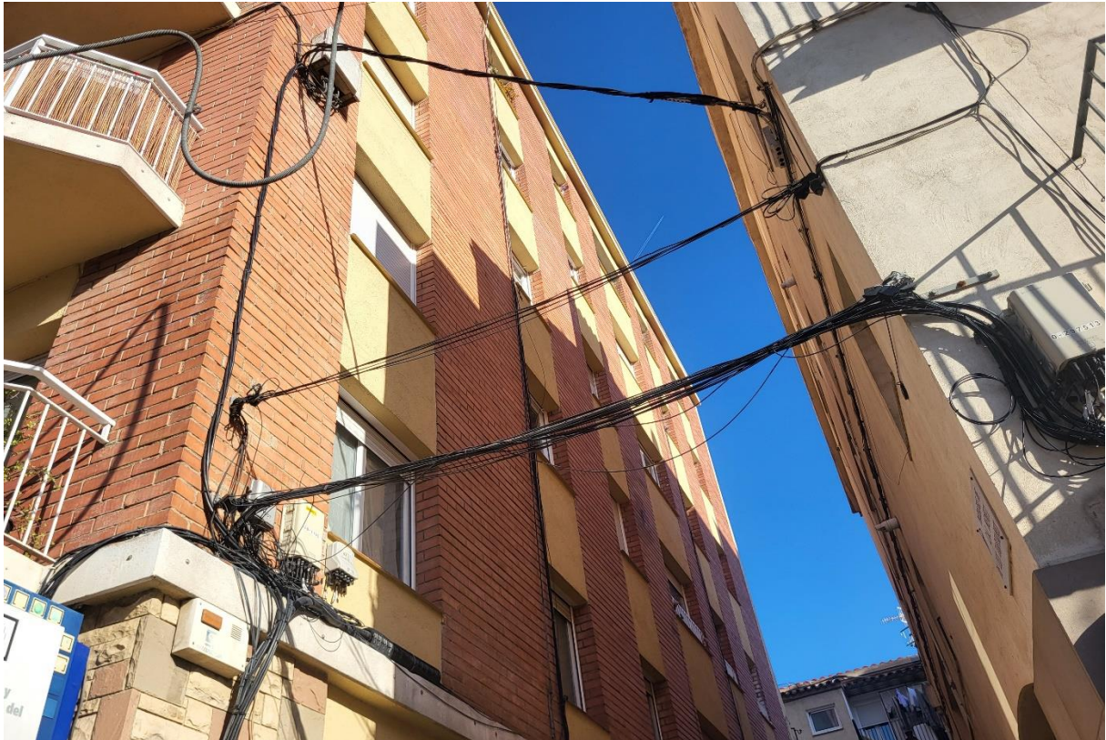
Fig 7. Exemple de línies aèries de la xarxa de telecomunicacions.
