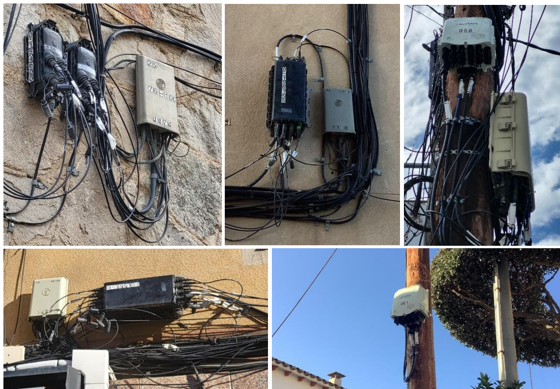
Fig 9. Exemple caixes de connexions a façana i postes de fusta.
