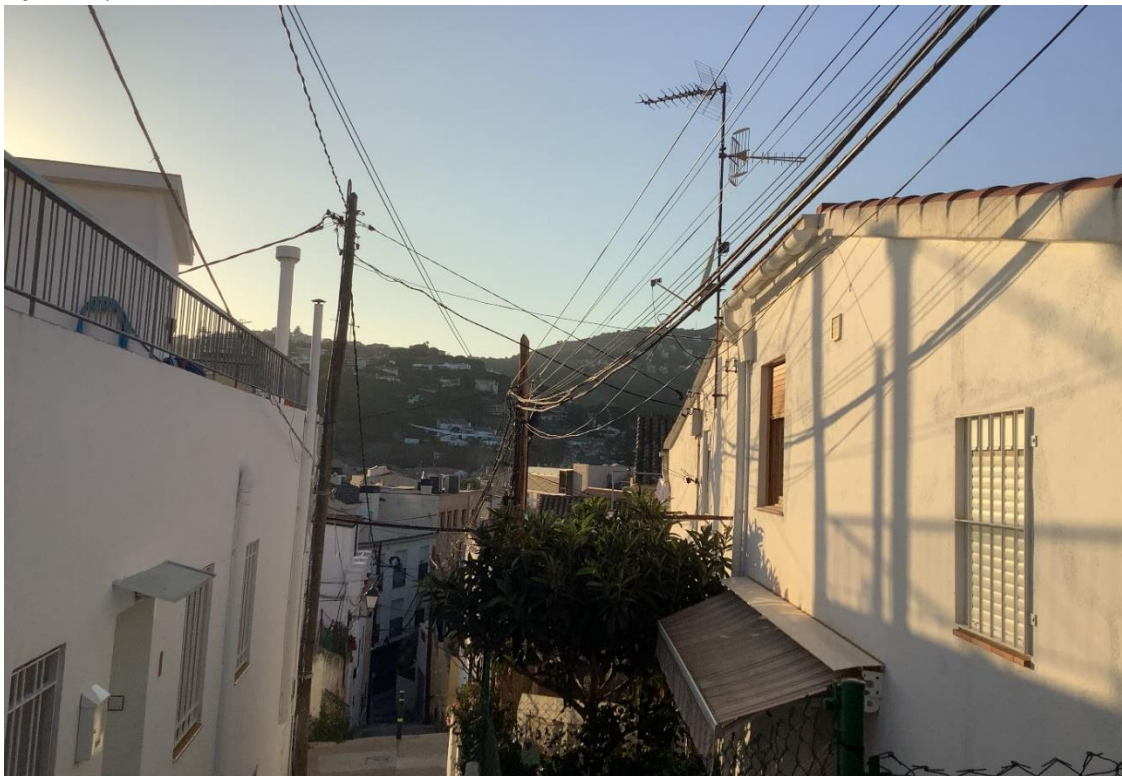
Fig 6. Exemple de línies aèries de la xarxa de telecomunicacions.
