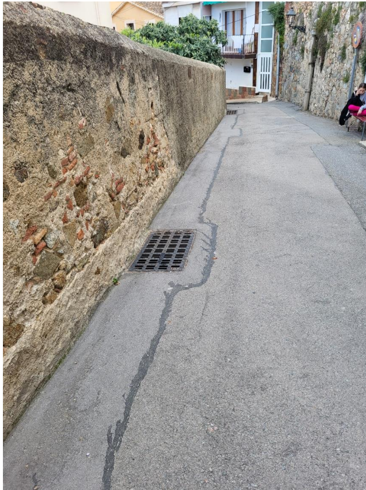
Fig 11. Embornals del tram de pluvials del carrer del Gurri.
