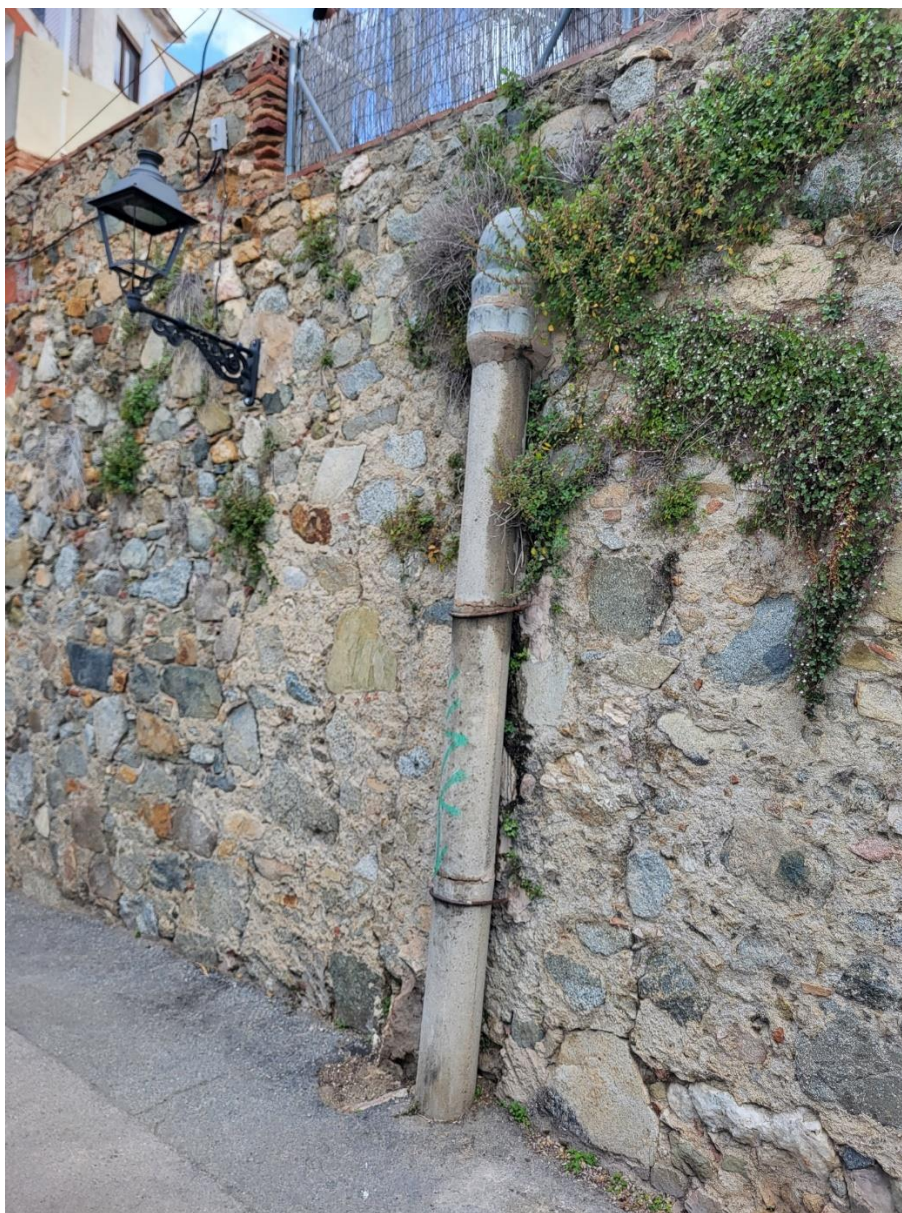
Fig 14. Tub de formigó que condueix les aigües pluvial recollides al núm. 3 del carrer Sant Josep al col·lector de pluvials del carrer del Gurri.
