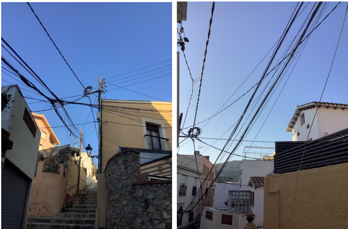
Fig 8. Exemple de línies aèries de la xarxa de telecomunicacions.
