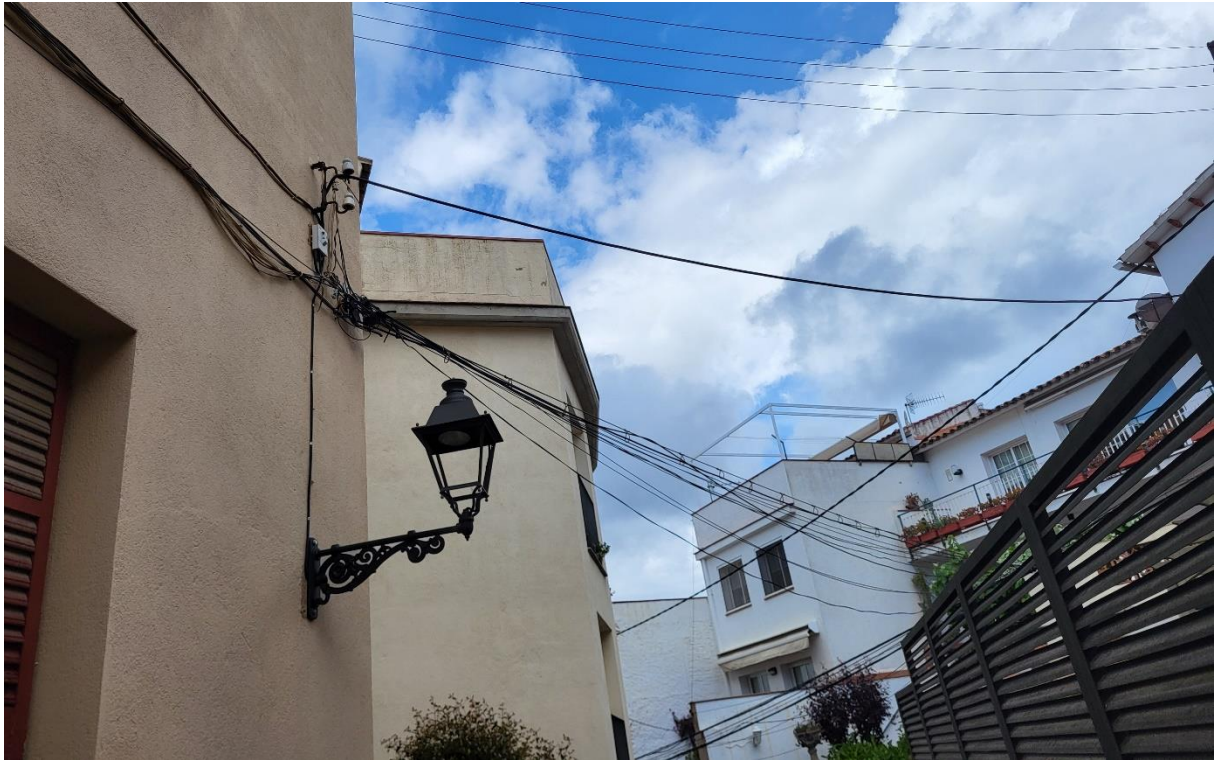
Fig 16. Luminaria amb braç grapada en façana.
