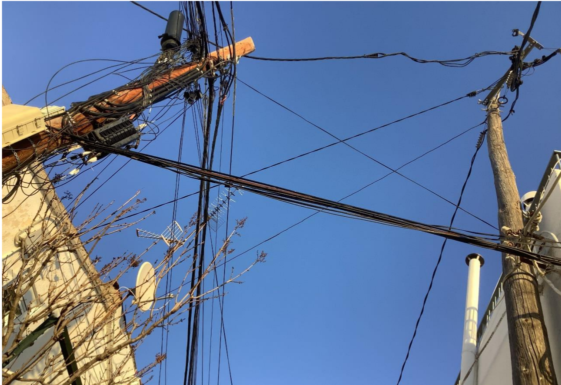
Fig 5. Exemple de línies aèries de la xarxa de telecomunicacions.
