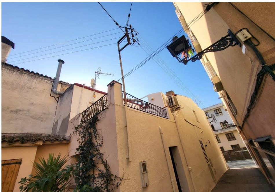
Fig 1. Línies aèries BT multifilar cable nu.
